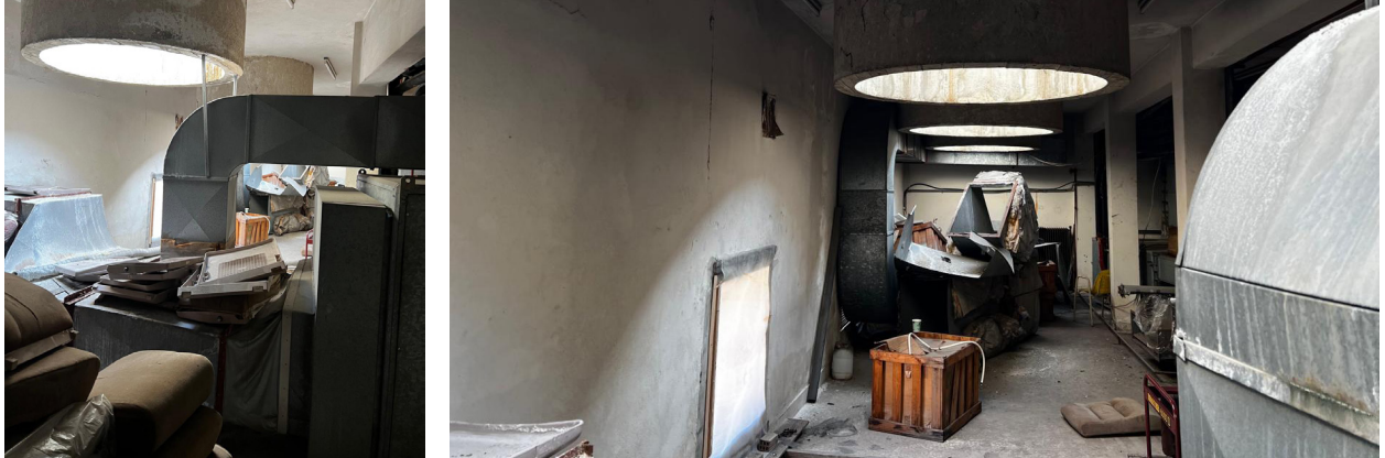
23, 24. Πρώην χώροι κοστούμιών με κατακόρυφους φεγγίτες έχουν καταληφθεί από εγκαταστάσεις Η/Μ
