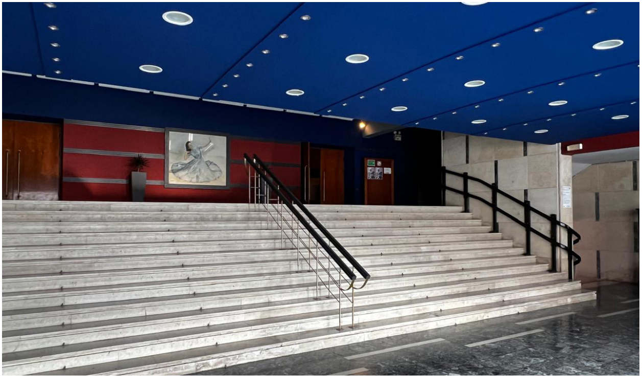
107. Μεταγενέστερες επεμβάσεις στην οροφή και τον χρωματισμό της εισόδου έχουν αλλοιώσει τη φυσιογνωμία της
